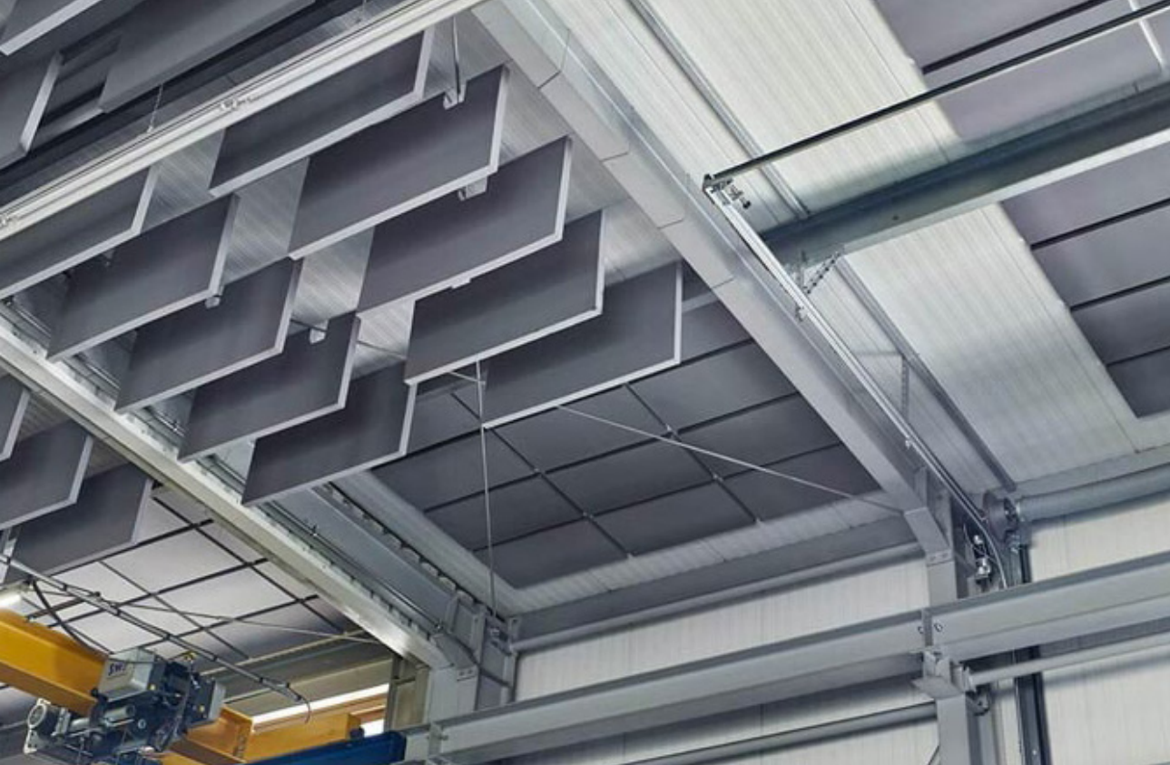
Abbildung 13 – Schallabsorber in einer Industriehalle
